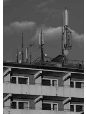
Mobilfunksendemasten direkt über der Wohnung. (Foto: Pixabay, CCo)
