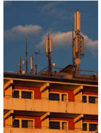
Mobilfunksendemasten direkt über der Wohnung. (Foto: Pixabay, CCo)
