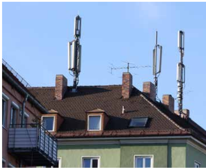
Mobilfunkantennen auf Wohnhausdach (Foto: Wikipedia, CC BY-SA 3.0)
