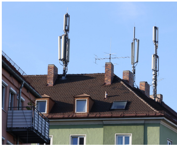
Mobilfunkantennen auf Wohnhausdach (Foto: Wikipedia, CC BY-SA 3.0)
